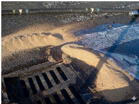
Ryc. 11. Zabezpieczenie studzienki sorbentem
