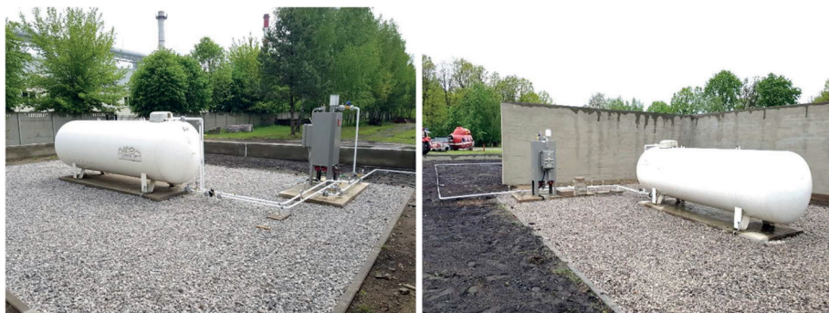
Ryc. 15. Stanowisko do badania pożarów strumieniowych (w tym parownik elektryczny o wydajności 200 kg/h (80 m 3 /h) i zbiornik naziemny 4,85 m 3 )
