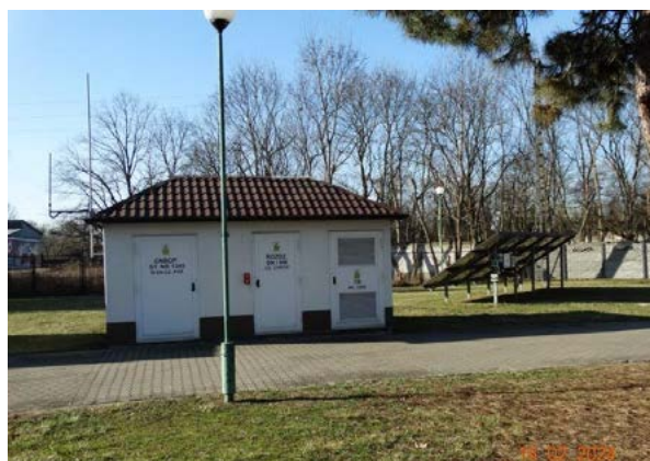
■ Stacja TRAF0 i nowa instalacja PV
