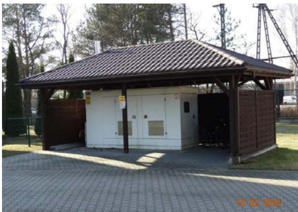
■ Agregat i budynek stacji TRAF0
