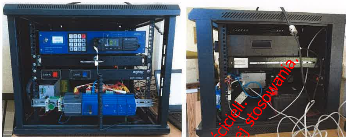
Fot. 2 i 3. Widok stacji bazowej HSR Źródło: CNBOP-PIB.
