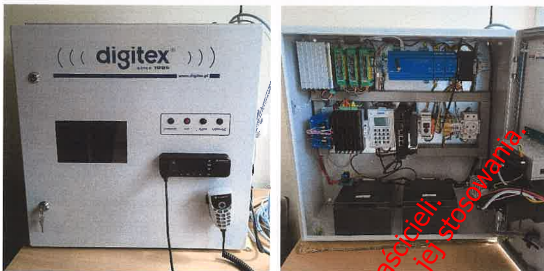
Fot. 5 i 6. Widok stacji mobilnej HSR
