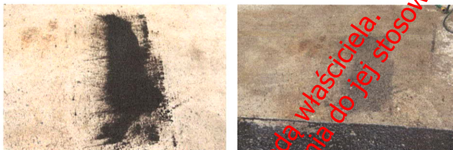
Fot. 3 i 4 Plama oleju przepalonego ciemnego przed i po czyszczeniu
