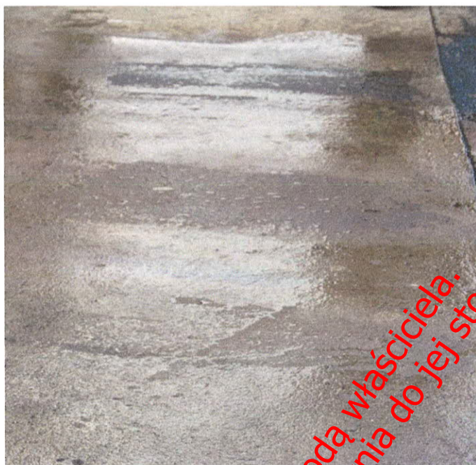
Fot. 9 Widoczny śliski film po czyszczeniu
