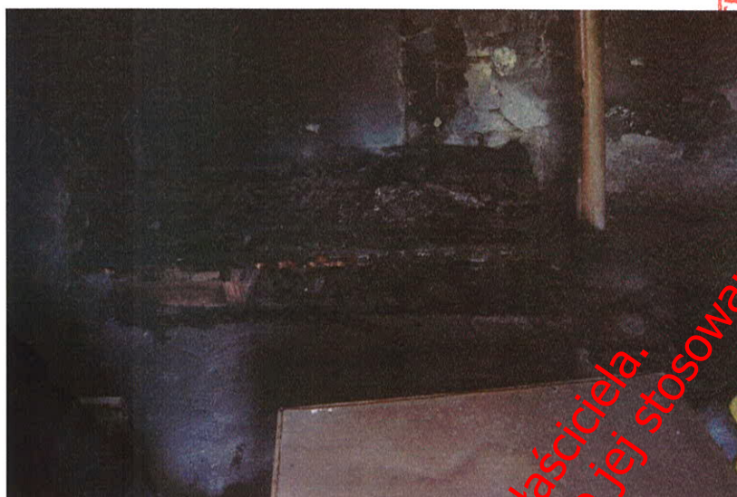
Fot. 5 Pomieszczenie po oddymieniu
