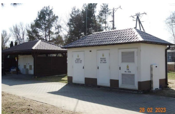
■ Agregat i budynek stacji TRAF0
