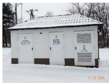
■ Agregat i budynek stacji TRAF0
