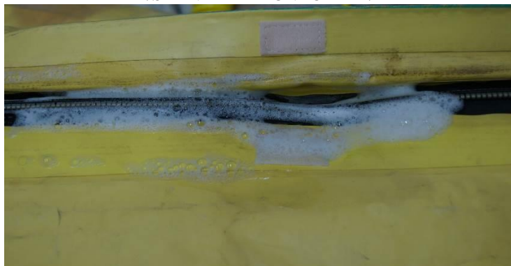
Ryc. 35. Zamek gazoszczelny prawidłowo uszczelniony Źródło: opracowanie własne
