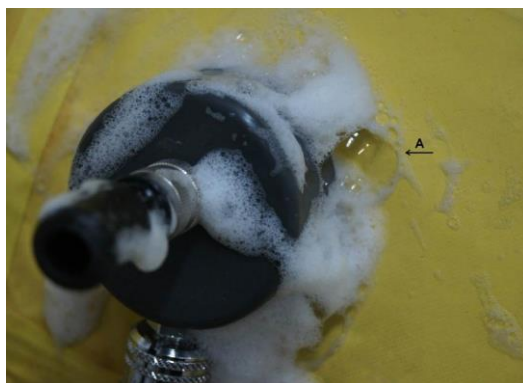
Ryc. 36. Pęcherze powietrzne w miejscu nieszczelności Źródło: opracowanie własne
