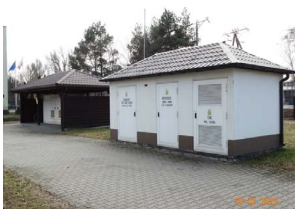
■ Agregat i budynek stacji TRAF0
