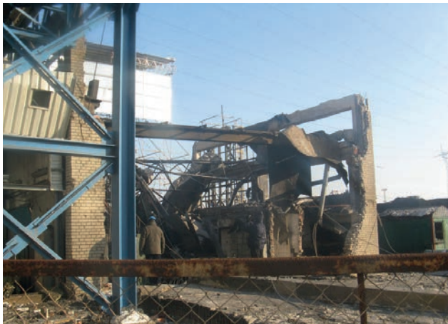
Ryc. 5. Stan budynków technicznych ciągu nawęglania po wybuchu
