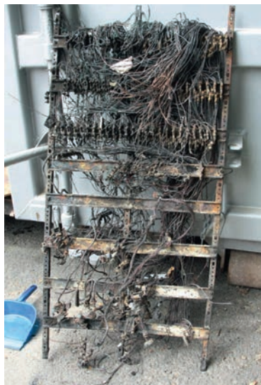
Ryc. 2. Widok spalonej tablicy bezpiecznikowej
