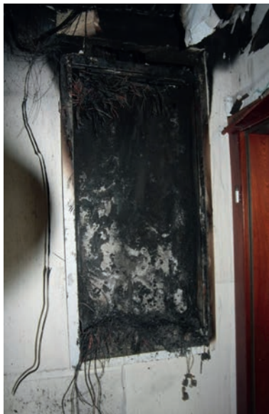
Ryc. 1. Stan miejsca zainstalowania tablicy bezpiecznikowej
