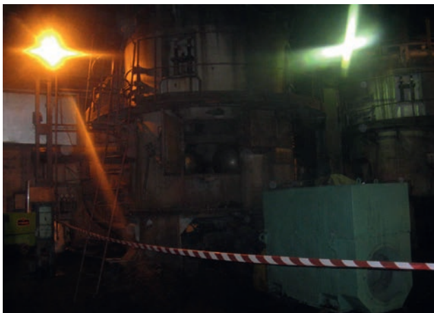
Ryc. 6. Młyny misowo-kulowe, w których zainicjował się pożar Źródło: Zdjęcie z akt szkody udostępnione przez ubezpieczyciela.
