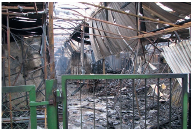
Ryc. 61. Widok zniszczonych stanowisk kupieckich
