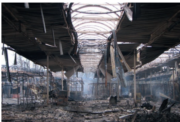
Ryc. 62. Widok zniszczonych stanowisk kupieckich
