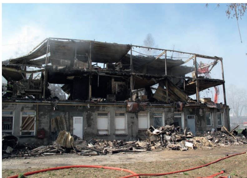
Ryc. 69. Widok zniszczeń spowodowanych pożarem
