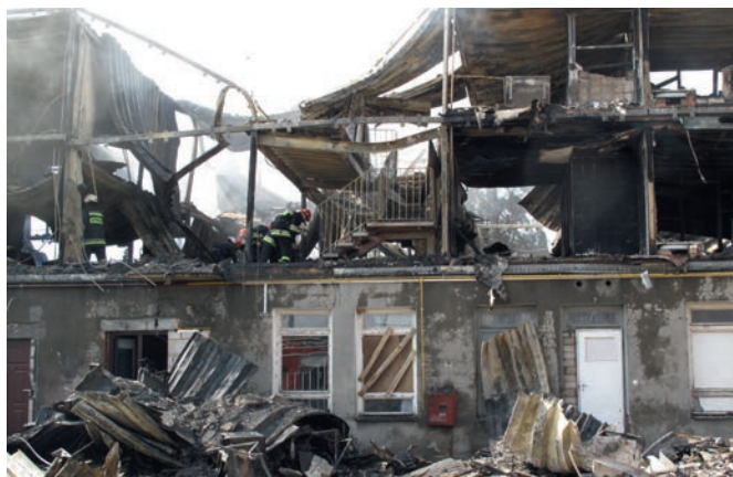
Ryc. 70. Widok zniszczeń spowodowanych pożarem
