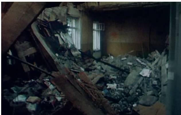
Ryc. 19. Widok pomieszczenia po zawaleniu się stropu Źródło: Znak zapytania , reportaż, TWF Poltel, 1980.
