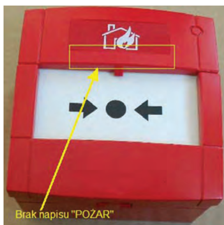
Ryc. 155. Ręczny ostrzegacz pożarowy bez napisu „POŻAR”. Brak może prowadzić do niewłaściwej interpretacji przeznaczenia i sposobu użycia urządzenia przez użytkownika
