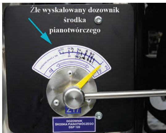
Ryc. 118. Źle wyskalowany dozownik środka pianotwórczego spowoduje zmniejszenie efektywności akcji gaśniczej, gdyż wytworzona piana będzie miała nieprawidłowe parametry
