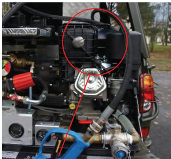
Ryc. 85. Wylot spalin na stanowisko obsługi – zagrożenie dla użytkownika w trakcie obsługi agregatu
