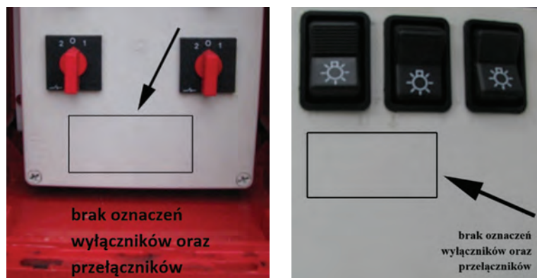
Ryc. 114. Brak oznaczeń wyłączników i przełączników – może utrudniać prowadzenie akcji ratowniczo-gaśniczej
