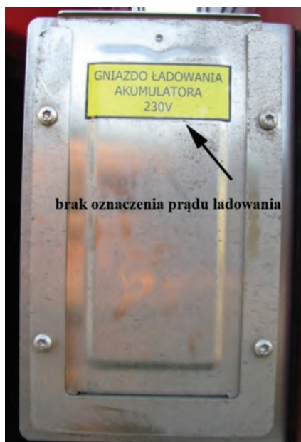
Ryc. 116. Brak oznaczenia prądu ładowania – niebezpieczeństwo nieprawidłowego podłączenia
