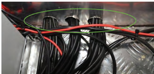
Ryc. 129. Przewody elektryczne poprowadzone przez otwory bez zabezpieczenia powierzchni blachy – zagrożenie w trakcie użytkowania (możliwość przecięcia izolacji, a więc porażenia prądem)
