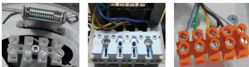
Ryc. 148. Plastikowa kostka przyłączeniowa w głośniku do DSO oraz brak bezpiecznika termicznego.
